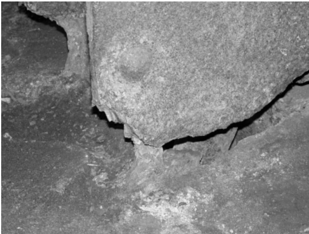
Bild 14: Stütze II, nach Begutachtung, Außenseite, rechts
