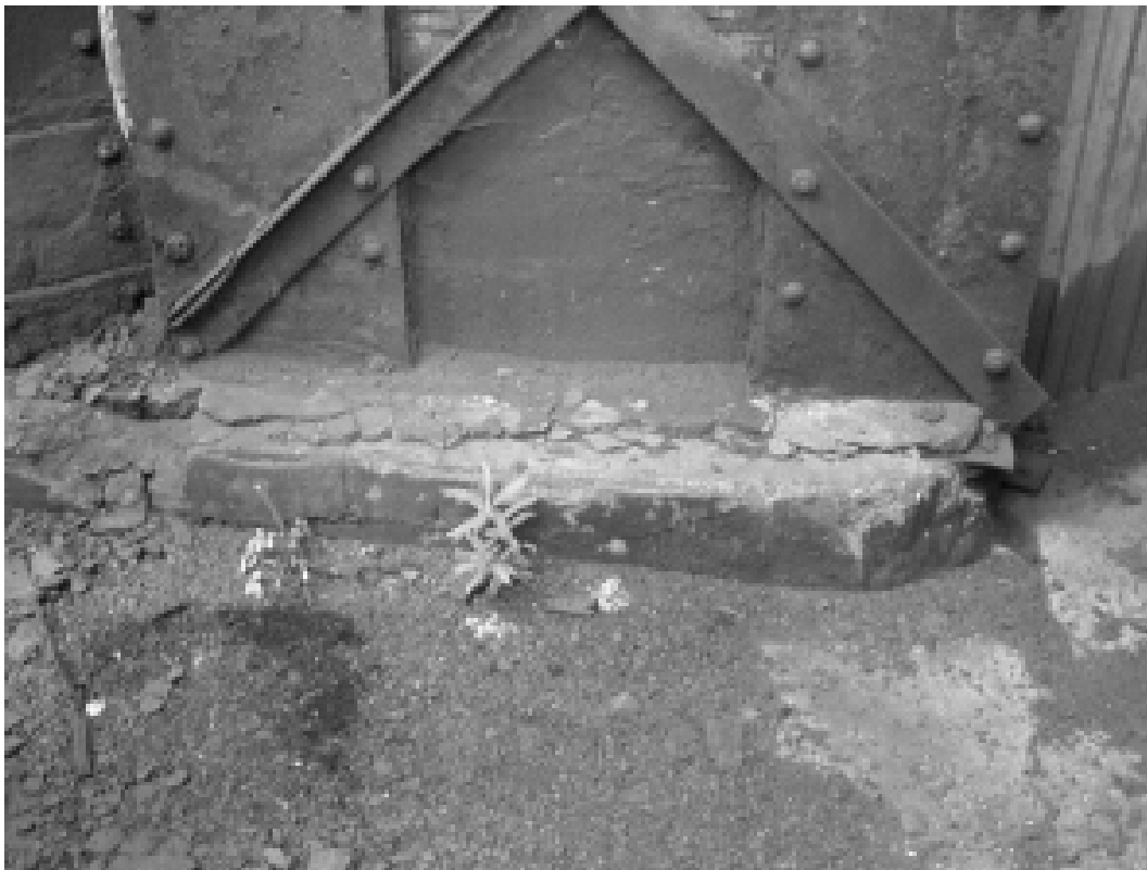
Bild 15: Stütze V, Ausgangszustand, Außenseite, rechts
