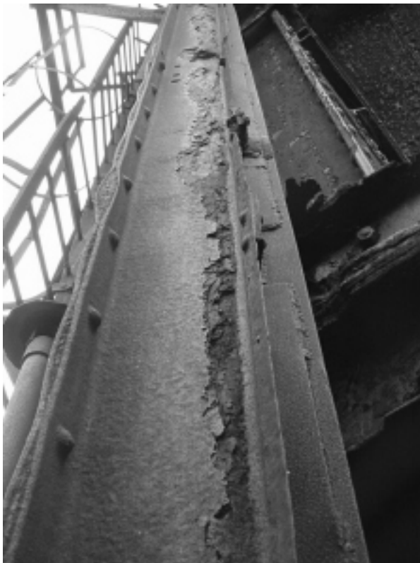
Bild 23: Aufblätterungen über weite Bereiche des U 200 (Stütze 2)
