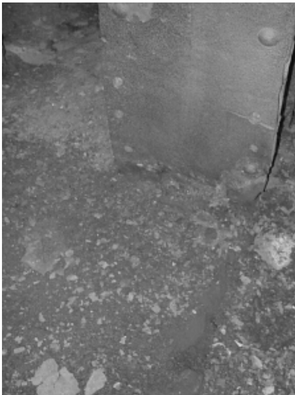
Bild 11: Stütze II, Ausgangszustand, Außenseite, links
