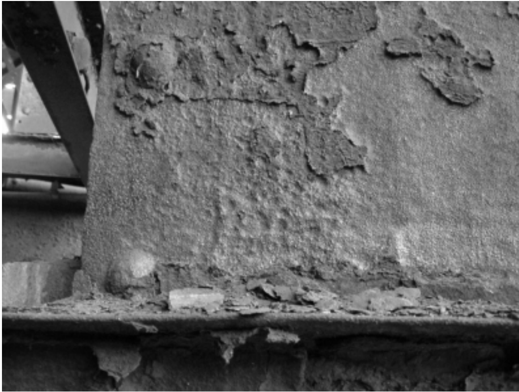
Bild 25: Flächige Korrosion mit Mulden
