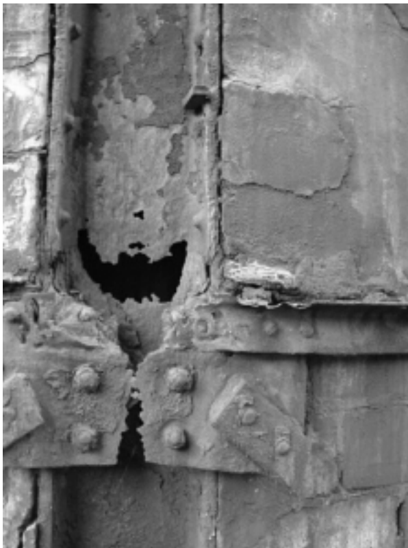
Bild 16: Stütze V, Loch über Knotenblech
