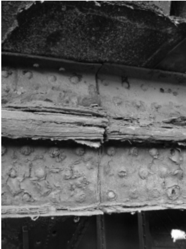
Bild 20: Aufwerfungen durch Korrosionsprodukte am umlaufenden U-Band
