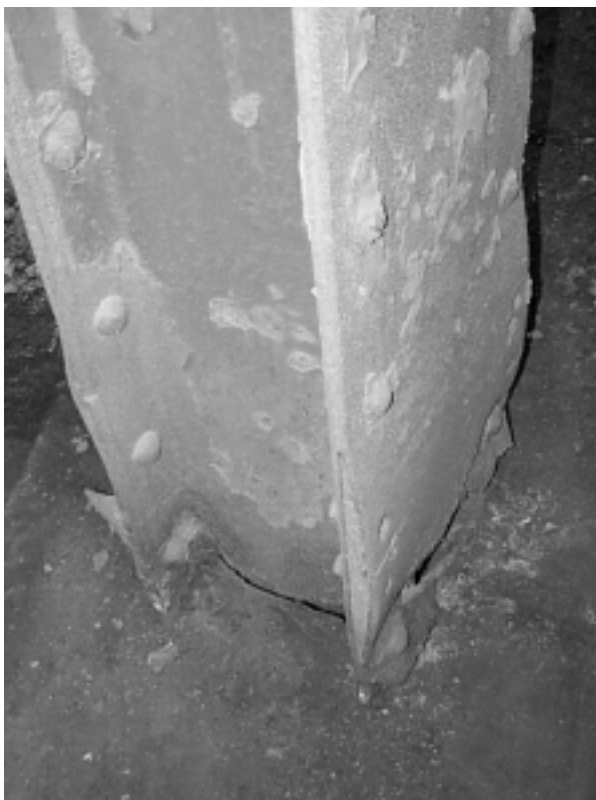
Bild 9: Stütze I, nach Begutachtung
