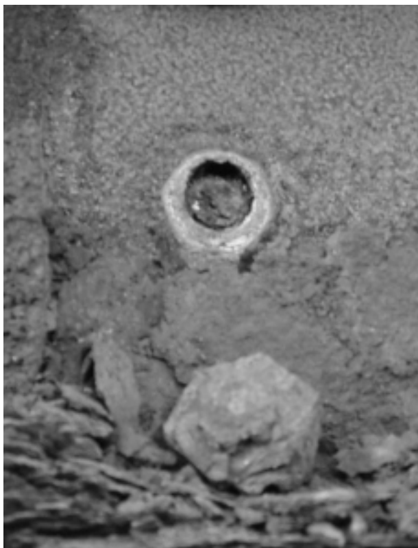
Bild 18: Durch Korrosion abgeplatzte Schraubenmutter
