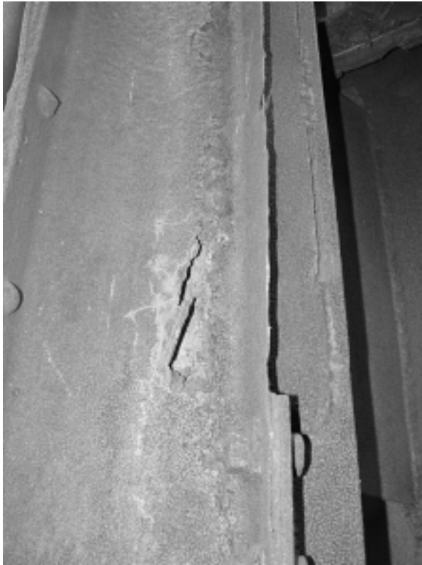
Bild 22: Aufblätterungen an U200 (Stütze 2)
