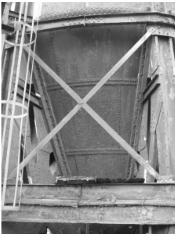
Bild 4: Oberes Stützkreuz zwischen Stütze II und III
