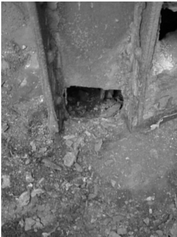
Bild 17: Stütze VII, Loch
