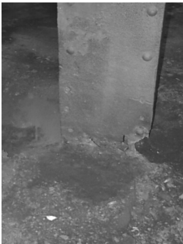
Bild 13: Stütze II, nach Begutachtung, Außenseite, links
